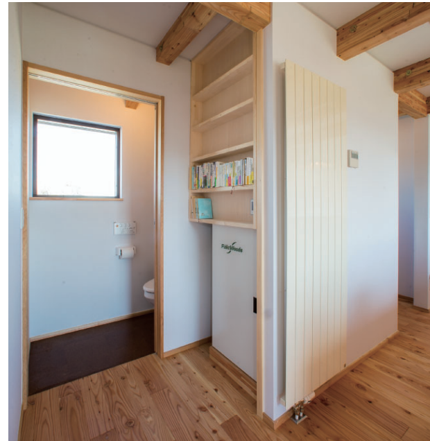
メンテナンスの容易な場所に RDAS を設置した事例。
